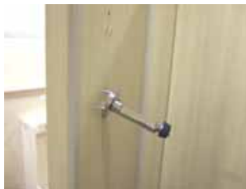
写真-1 破損した荷物掛
