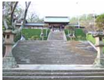
写真-3 手すりの無い階段
