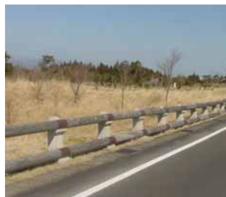
図-1 十年経過木製ガードレール
