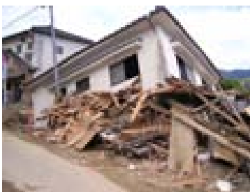
写真 1 倒壊した家屋
