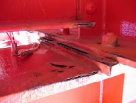
図-1 橋梁の腐食
