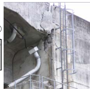
写真-1 桁衝突の痕跡
