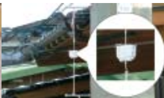
図 - 3 塩分捕捉器設置状況
