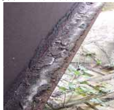
写真-2 腐食状況
