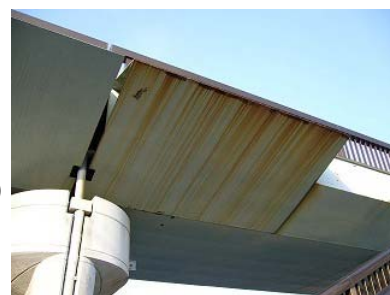
図-1 鋼橋の錆発生状況
