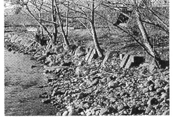
写真-4 コンクリート枠工出水後 (1999.12)
