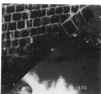
図-2 漏水の状態
