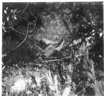
図-1 アーチ石のひび割れの状態
