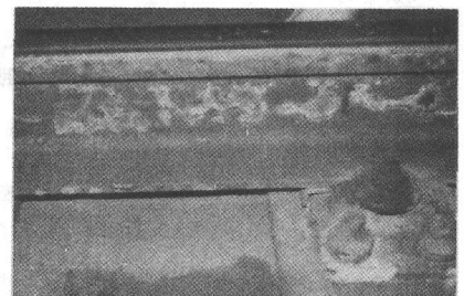
写真1 亜鉛アルミ合金溶射レール
