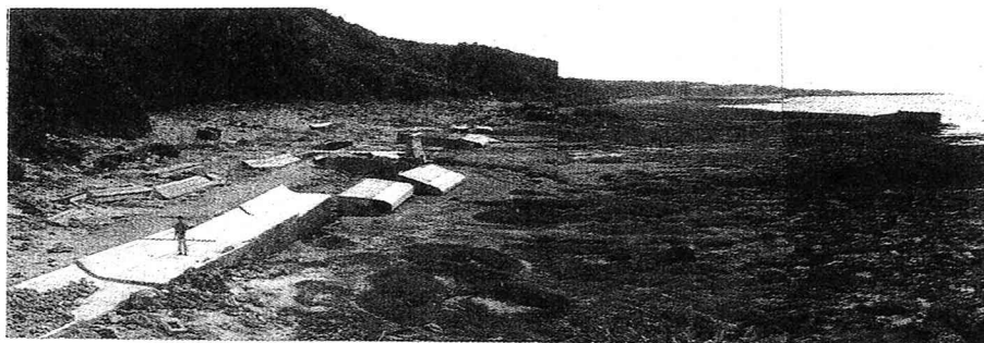
写真-2 久米島北海岸における被災後の護岸の状況
