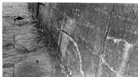
写真-3 コンクリートの亀裂(幸崎西防波堤)
