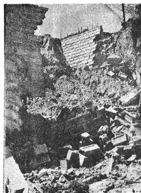
写真-10、ブロック擁壁の崩壊例 (鹿児島市内)
