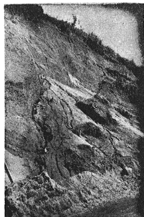
写真-12、切土工事中の崩壊例 (鹿児島市内)
