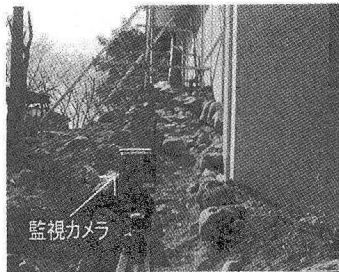
写真-1 監視カメラの設置
