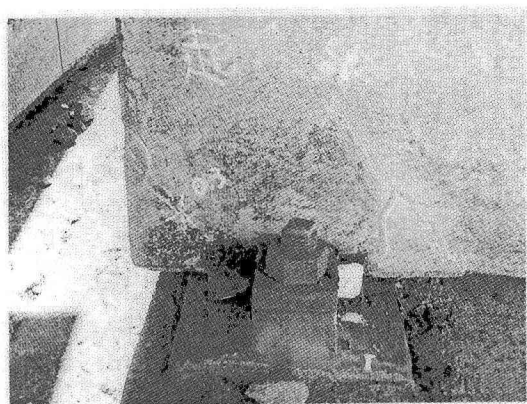
写真-2 支承部付近の変状
