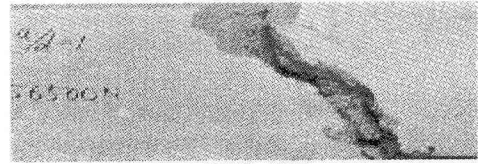
ひび割れ状況
