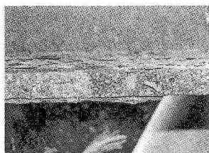
写真-3 ウエハース状の錆
