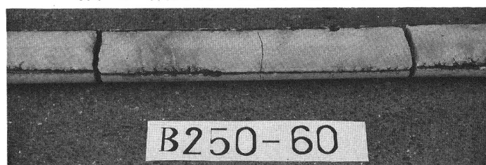
写真-3 崩壊モルタル貫通クラック (B250-60)
