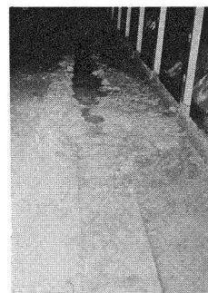
写真4 導水部劣化状況
