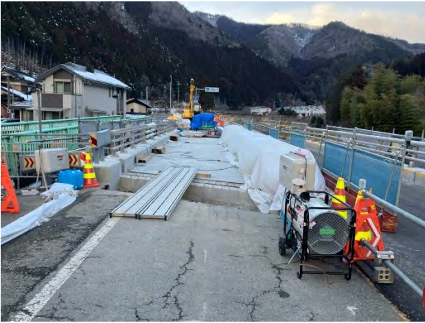
図-9 テントとジェットヒーター
