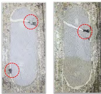
図-9 1年経過後のHJ部の欠損状況
