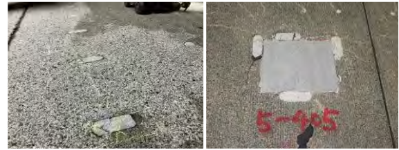
図-5 HJ部の変状状況 a)と従来の補修状況 b)
