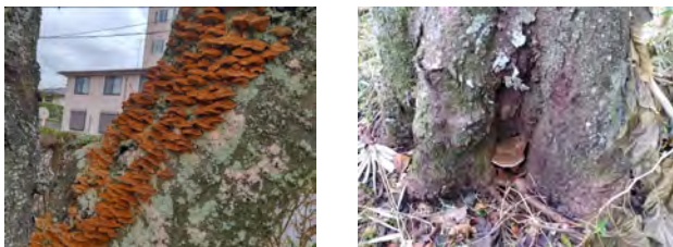
写真-5 目視点検により見つかったキノコ
