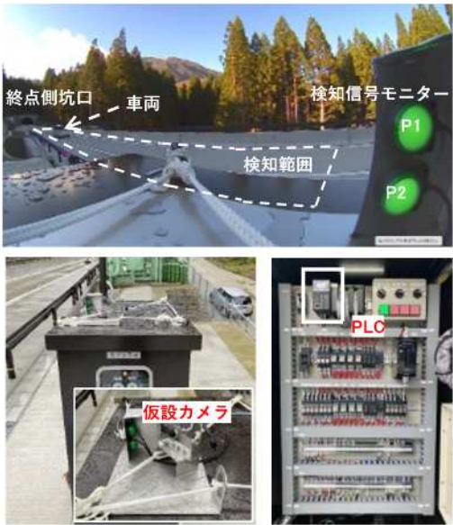
図-3 仮設カメラ映像（上段），仮設状況（下段左），分電盤内部（下段右）
