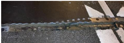
写真-1 突合せ型鋼製ジョイントの損傷状況
