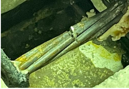
図-2 鋼材破断途中の状況
