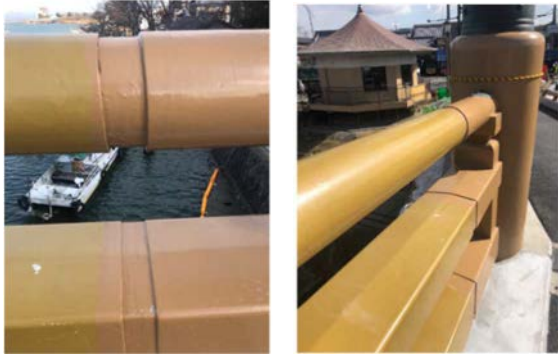
図-13 高欄の新旧の塗装の色の差
