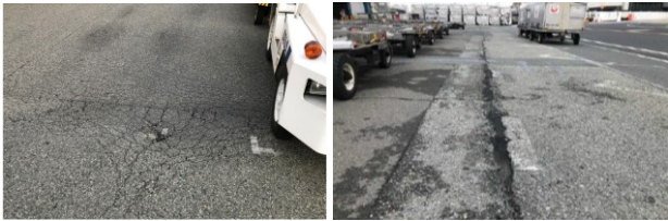
(a) 亀甲クラック (b) 段差
