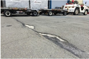
(c) アスファルト舗装の剥がれ 図4 舗装の破損状況
