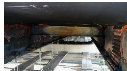
写真-1 鋼桁と床版下面の損傷 1)
