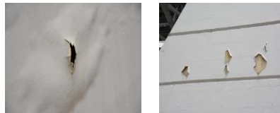
図-1 表面被覆材における変状
