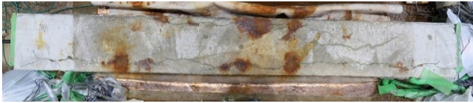
図-3 腐食促進終了後の MBC-RC
