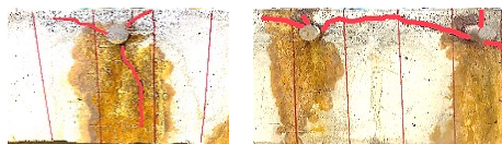
図3 側面ひび割れの様子 (左:下部鉄筋なし 右:下部鉄筋あり)
