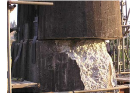
図 1 新潟県中越地震で被災した魚野川橋梁 14P 橋脚 1)
