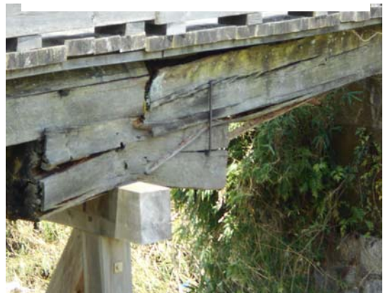
写真-2 中間橋脚上の損傷
