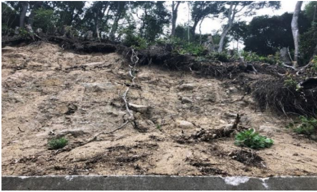
写真 2 京都府A道路斜面崩壊箇所
