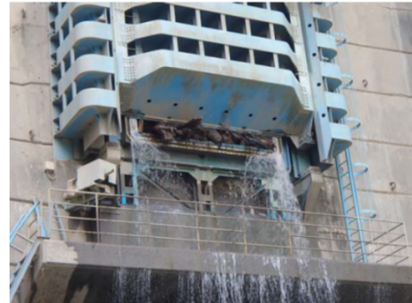
図1 閉塞した裾花ダムのコンジットゲート 1)
