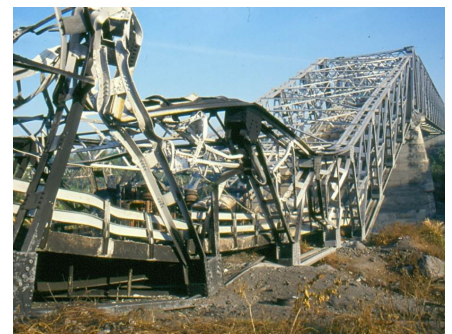
写真-2 落橋事例 (インドネシア)
