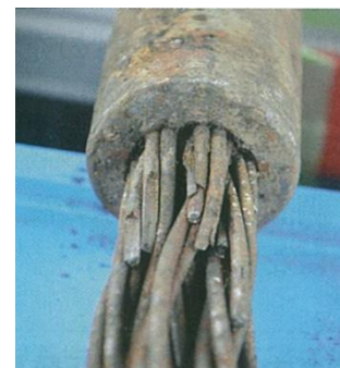
写真-1 PC 鋼線の破断 1)
