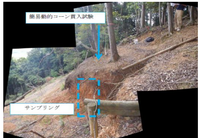
写真-1 崩壊地の状況
