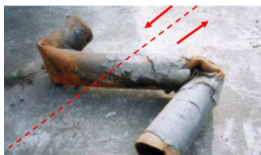
写真 1 断層変位による被害 1)
