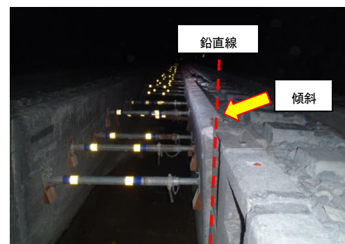
写真－1 側壁傾斜状況
