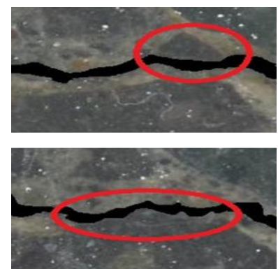
図-2 骨材に沿って生じたひび割れ
