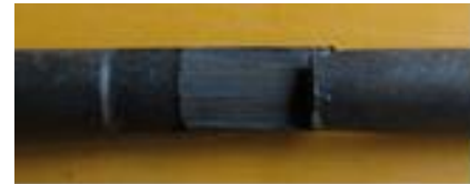
写真-2 電食による応力腐食割れ
