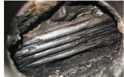
写真-1 既設 PC の腐食状況
