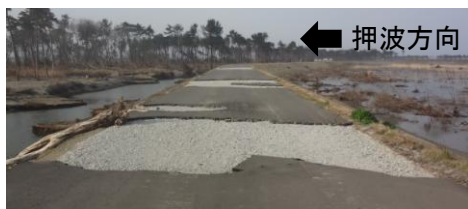
写真-1 井土浦の被災状況
