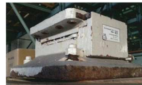
写真 - 1 劣化支承写真
