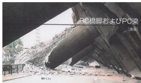
図-3 倒壊ピルツ橋脚の代表例 8)
