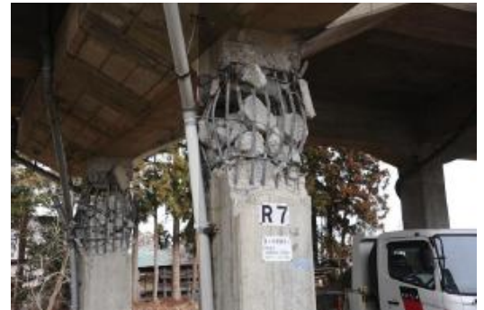
写真1 被災した柱の損傷状況
