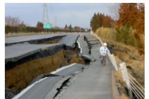
写真-1 被害状況
