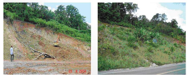
(a)崩壊時(2004年) (b)計測器設置前(2007年)
