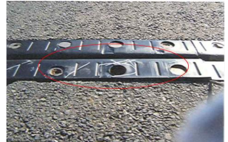
写真 1 伸縮装置の損傷例（ボルト緩み）
